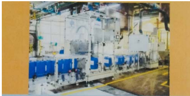
แบ่งเป็นเขตที่มีการติดตั้งเครื่องจักร
